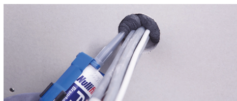
Sellado de pasos de cables
